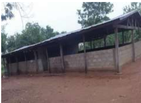
Photo 18 : Etat des bâtiments scolaires au Lycée de Broukou
