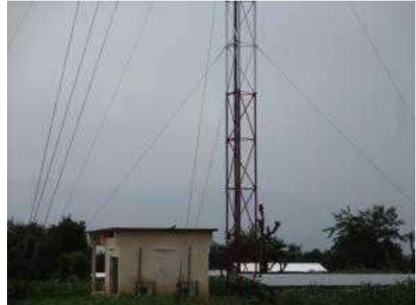
Photo 34 : Vue d'une antenne de télécommunication à Broukou
